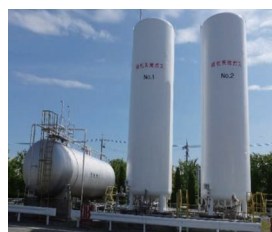
LNGプラント(小松工場)
