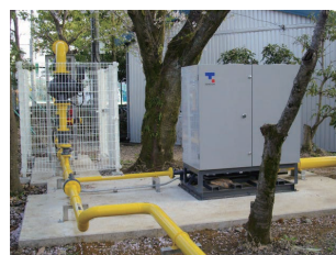
都市ガス設備
