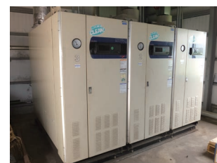
ボイラー(小松工場)
