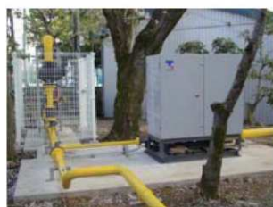
都市ガス設備
