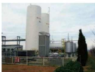
LNG プラント
