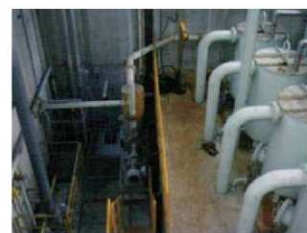
塗装カス回収設備
