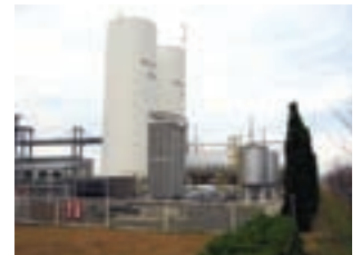
LNG プラント
