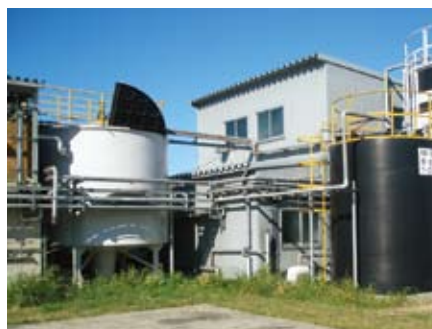
排水処理施設
