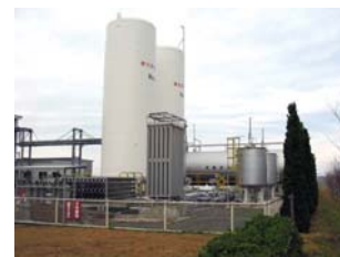
LNGプラント
