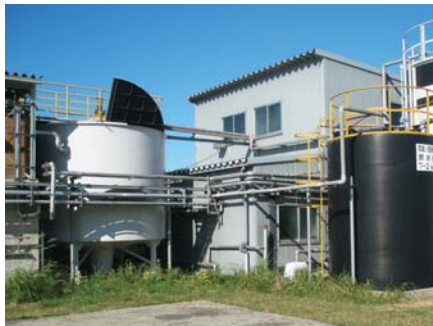
排水処理施設
