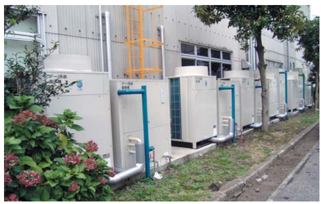
氷蓄熱式空調設備
