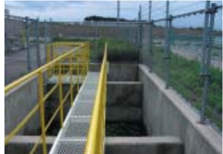
油水分離槽 農業用水路への排水濃度を監視・測定
