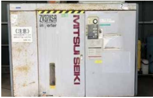
コンプレッサー更新 計2台
